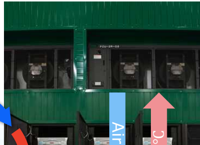
Fan Coil Unit (FCU)
